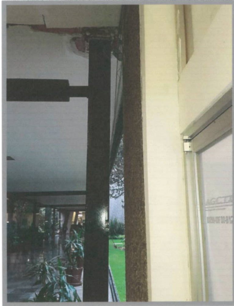
Foto 19 Desplomo en puente peatonal de acero que conduce al Cuerpo A
