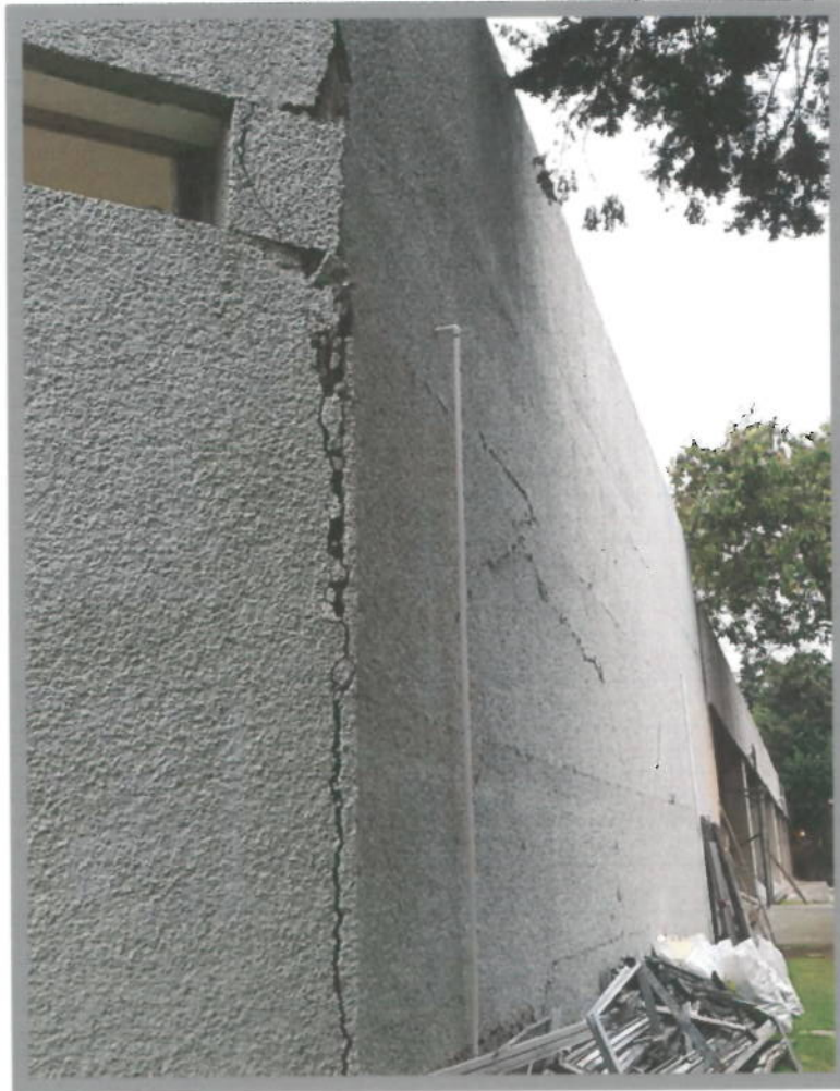
Foto 15 Desprendimiento de acabado de muros de fachadas (No es daño estructural); sin embargo, se recomienda delimitar su zona adyacente como insegura mientras se retira el aplanado suelto
