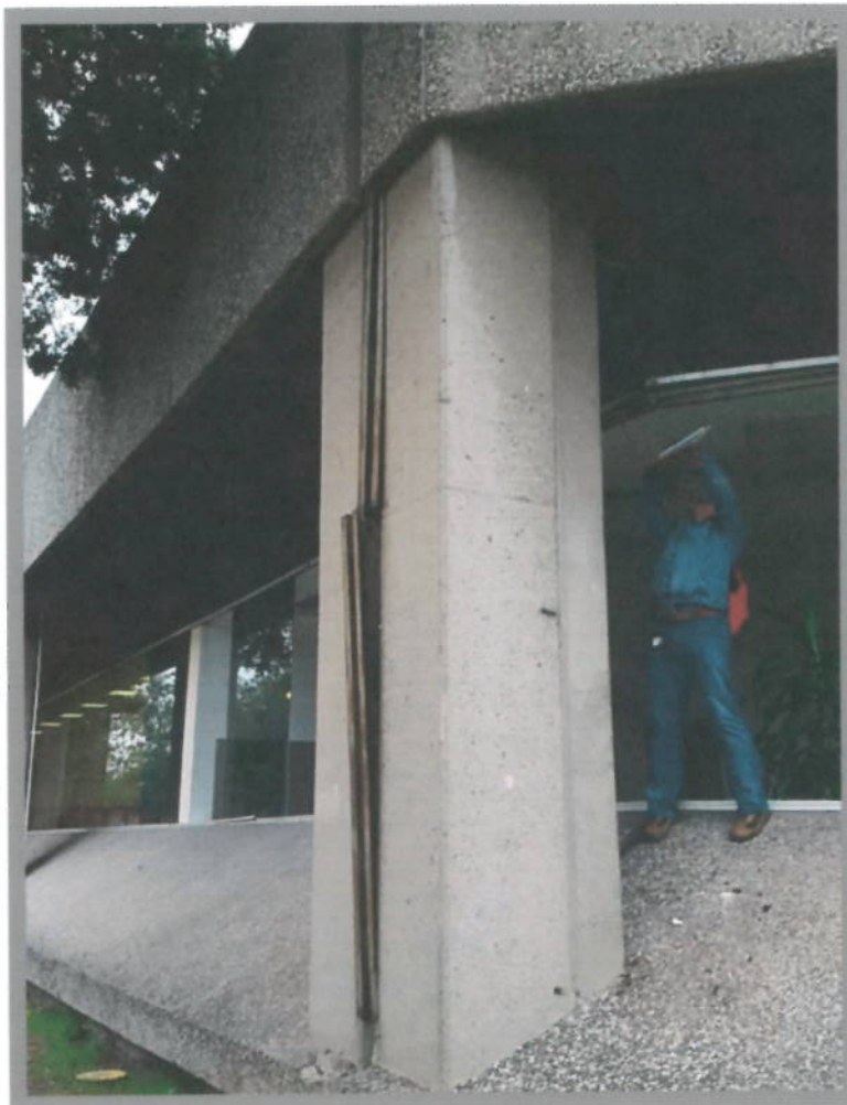
Foto 6 Choque en pretil de azotea entre junta de edificios (vista desde abajo). Cuerpo H con F. Inspección detallada
