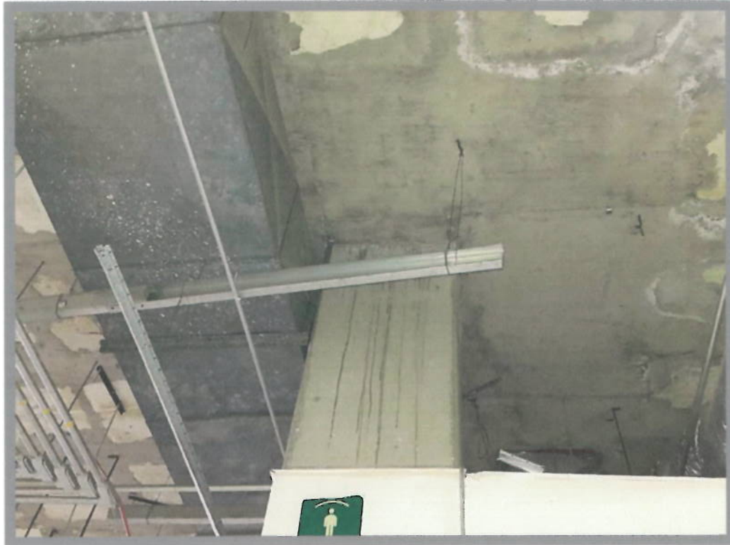
Foto 2 No hay daño estructural en columnas ni capiteles (unión de losa con columnas)
